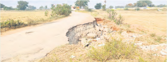
వారస తీసుకొని ప్రమాదకరంగా ఉన్న రోడ్డు గుంటను పూడిపించే ఏర్పాటు చేసి ప్రమాదాలు జరగకుండా చూడాలని ప్రయాణికులు కోరుతున్నారు.
